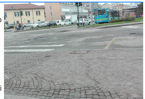
Degrado di fronte alla stazione dello Stato
